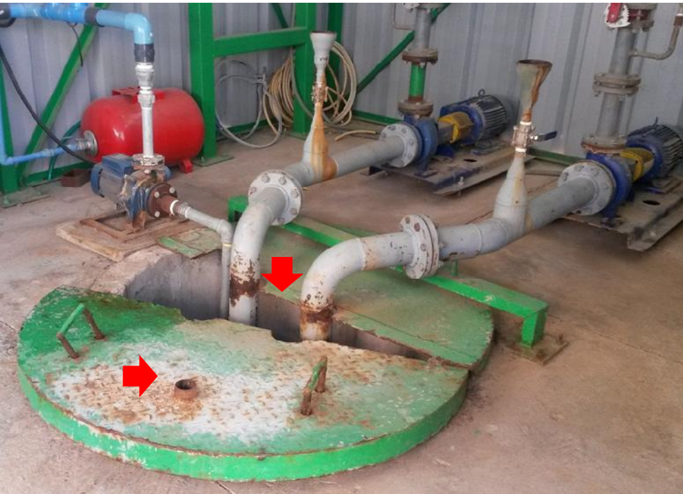
Tapa Protectora del Pozo #3
